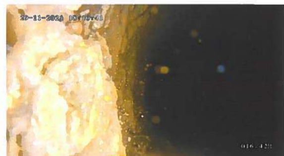
4, 00:04:01, 11.00m Grossa formazione di depositi duri nella giunzione, da ore 12 a ore 12, inizio danno
