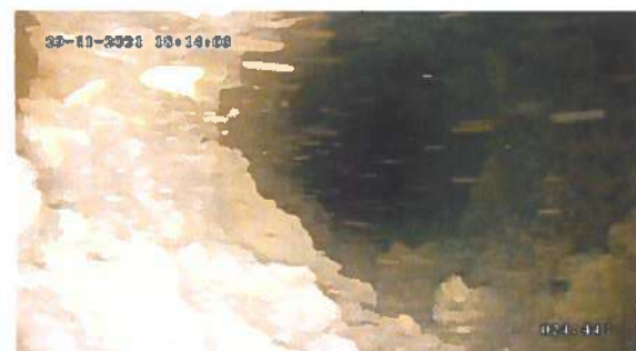
6, 00:08:48, 24.50m Grossa formazione di depositi duri nella giunzione, da ore 12 a ore 12
