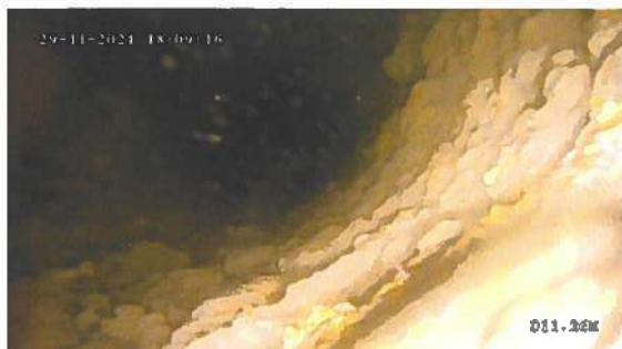
3, 00:04:01, 11.00m Grossa formazione di depositi duri nella giunzione, da ore 12 a ore 12, inizio danno
