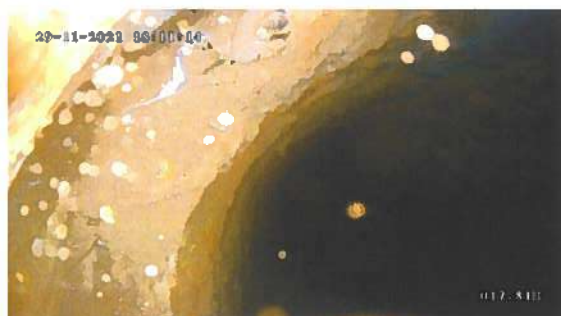
5, 00:06:00, 18.00m Medio distacco giunzione tubazione da ore 12 a ore 12
